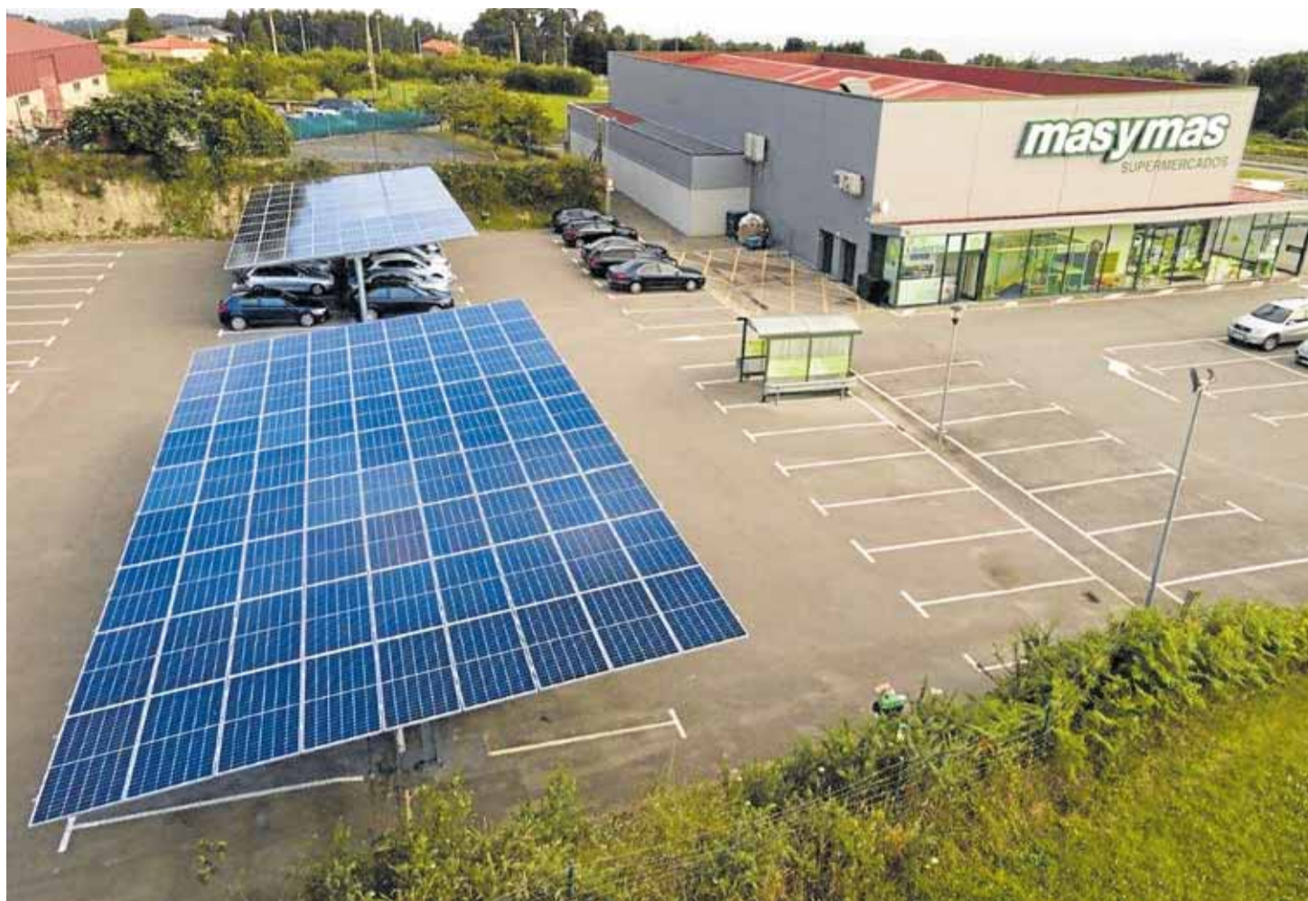
Placas solares instaladas en un supermercado de masymas. e. c.
